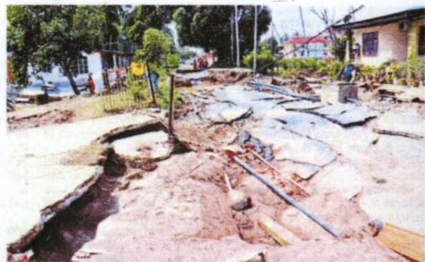
Jalan utama ke Pantai Cahaya Bulan dan bandar Kota Bharu terputus akibat kesan arus deras banjir. (FOTO NIK ABDULLAH NIK OMAR/BH)
