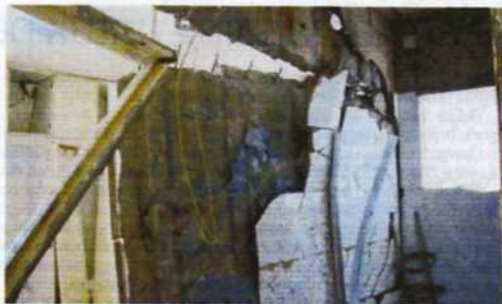
DINDING rumah lelaki Britain berkenaan retak teruk kesan letupan kuat daripada alat pemanas air di siling tandasnya di Kondominium Mont Kiara Palma, Kuala Lumpur semalam.
