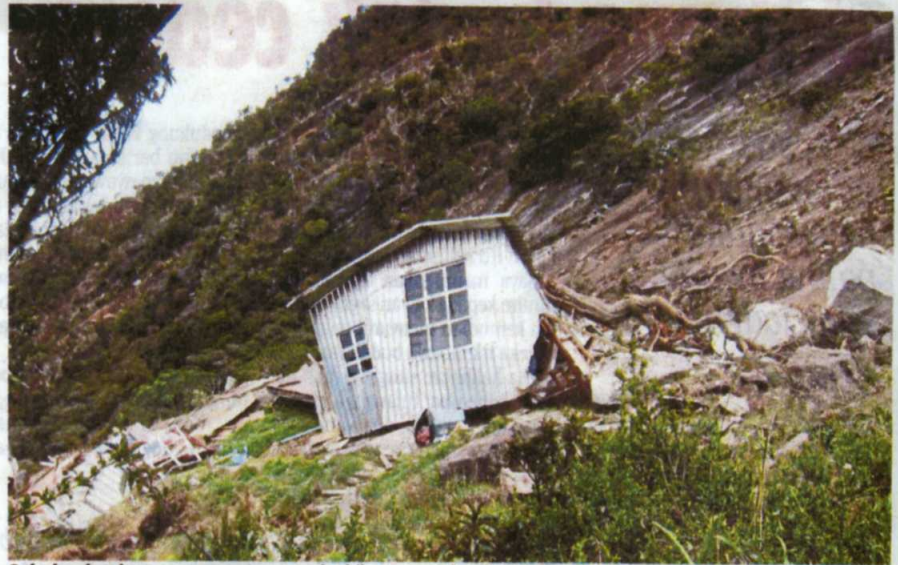
Sebahagian bangunan yang musnah akibat gempa bumi di Laban Rata, Gunung Kinabalu.
