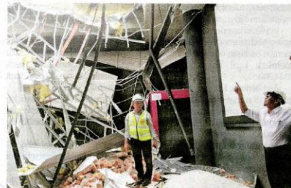
Mohd Sofi melihat keadaan dinding bangunan Planetarium Melaka yang runtuh.
