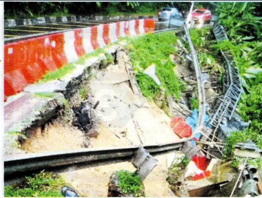
KEADAAN lokasi tanah runtuh di Jalan Paya Terubong antara Green Garden, Persimpangan Jalan Paya Terubong dan Jalan Tun Sardon.
